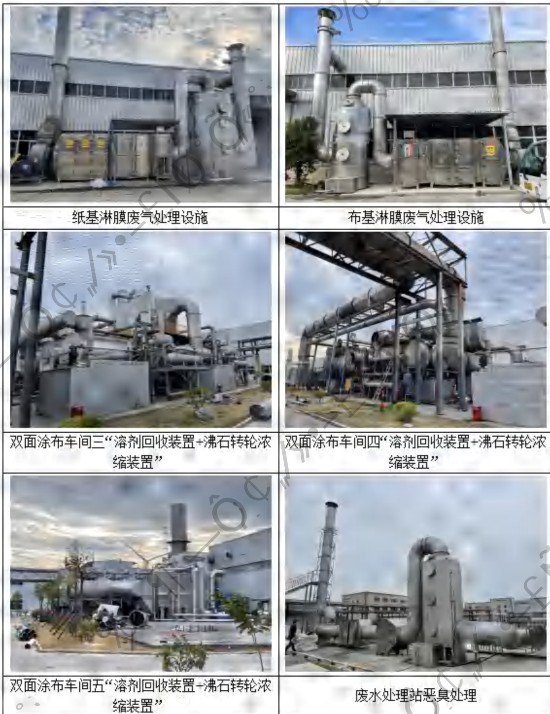
图 4.1-4 有组织废气治理设施
